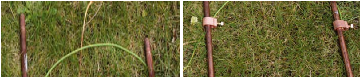
Figure 4. Tiges de prise de terre reliées entre elles avant d'être enfoncées dans le sol 5 .
